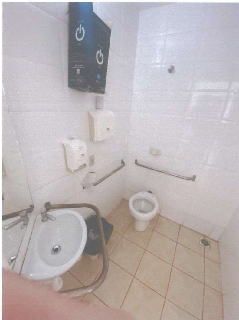
Foto 06: Suportes metálicos oxidados.
