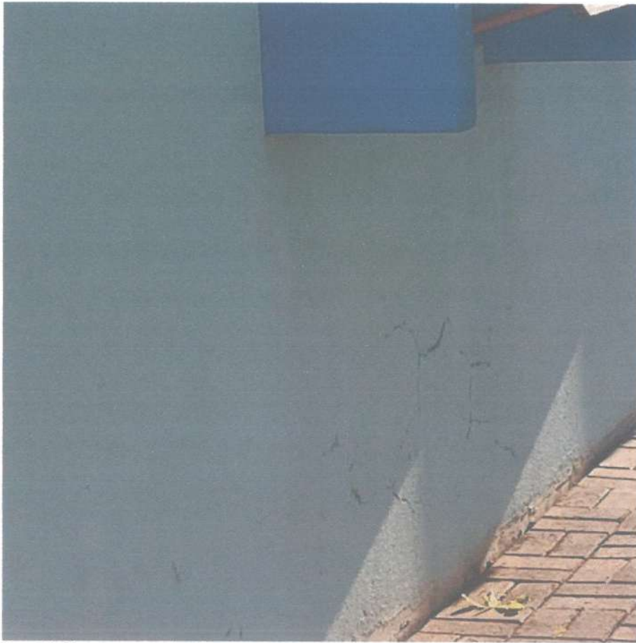
Foto 01: Pintura externa danificada, reboco mapeado.
