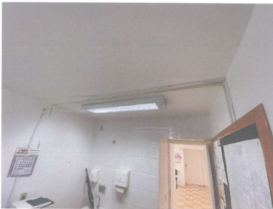
Foto 07: Instalações elétricas fora de conformidade.
