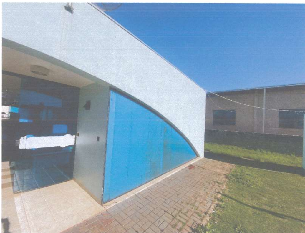
Foto 04: Vidro dos fundos quebrado.
