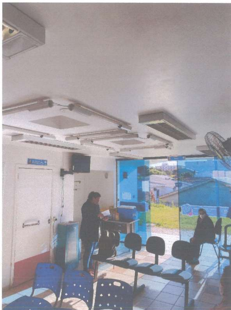
Foto 08: Iluminação com peças defeituosas.
