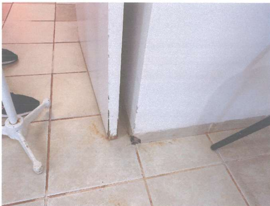
Foto 05: Roda pé e pintura interior danificados.
