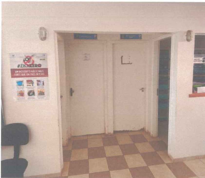
Foto 02: Porta dos consultórios deterioradas.
