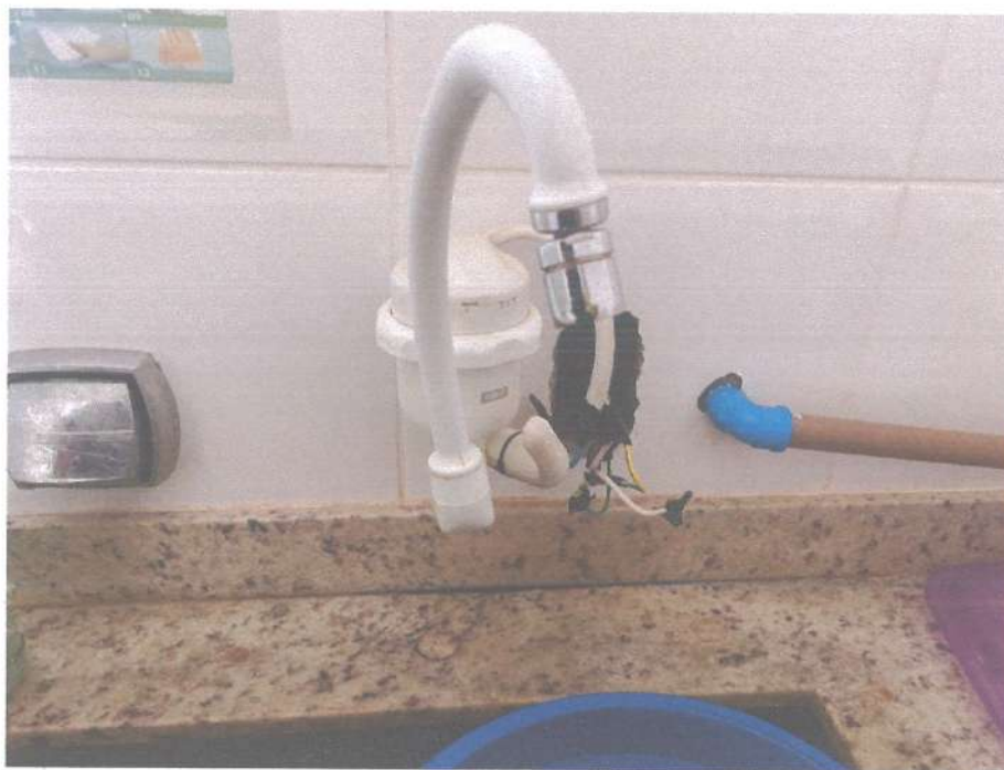
Foto 08: Instalações elétricas e hidráulicas fora de conformidade.
