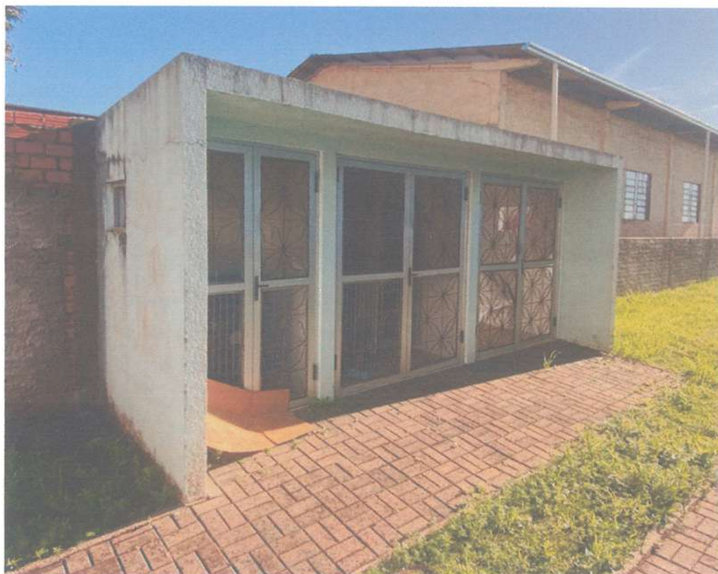
Foto 03: Casinha externa com pintura danificada.
