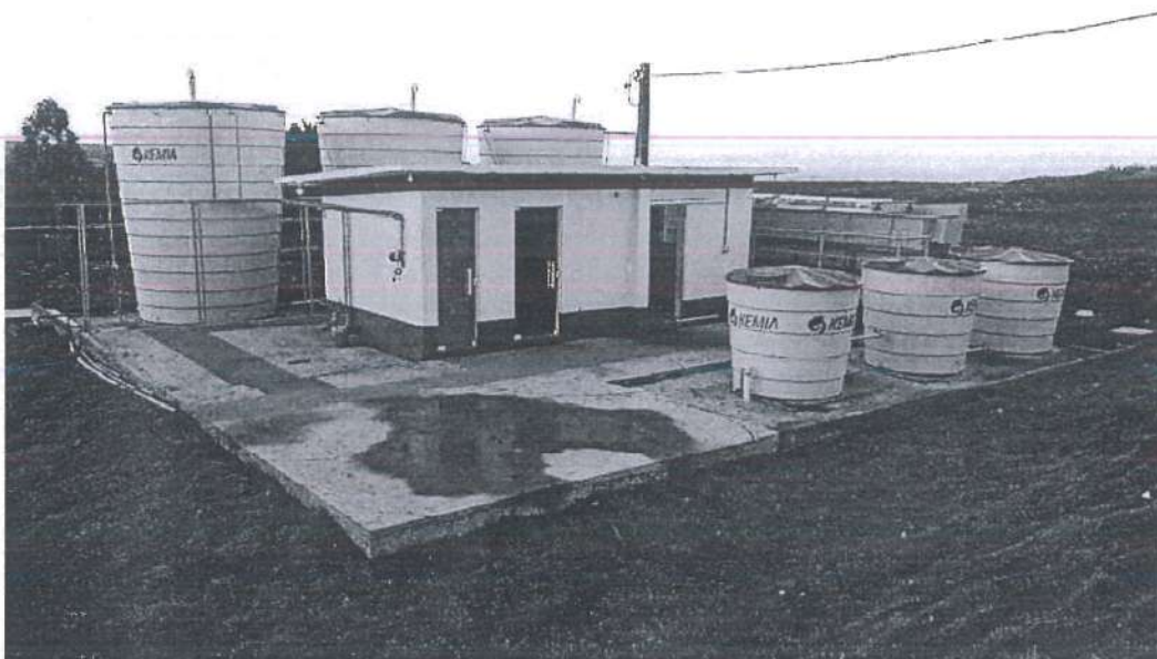
Figura 3.14: ETE – Estação de Tratamento de Efluentes Líquidos Industriais de Alta Eficiência. Fonte: Pijack Engenharia, 2017.
