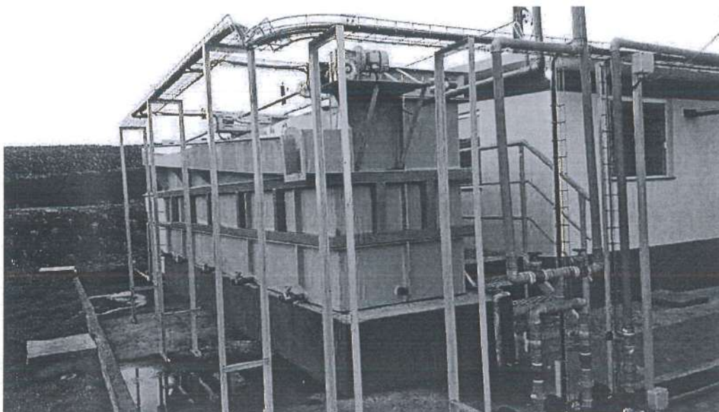
Figura 3.15: ETE – Reator de Eletrofloculação e Oxidação de Alta Eficiência. Fonte: Pijack Engenharia, 2017.
