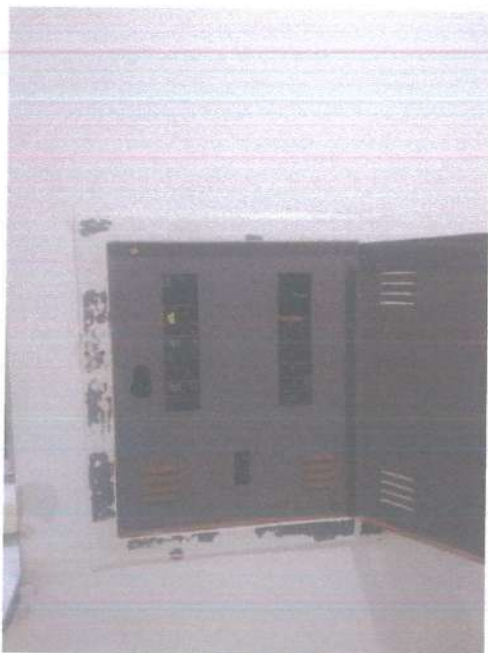
QUADRO DE DISTRIBUIÇÃO E DISJUNTORES SALA DE VACINAS
