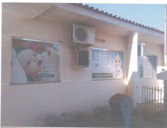
ENTRADA DE ENERGIA
