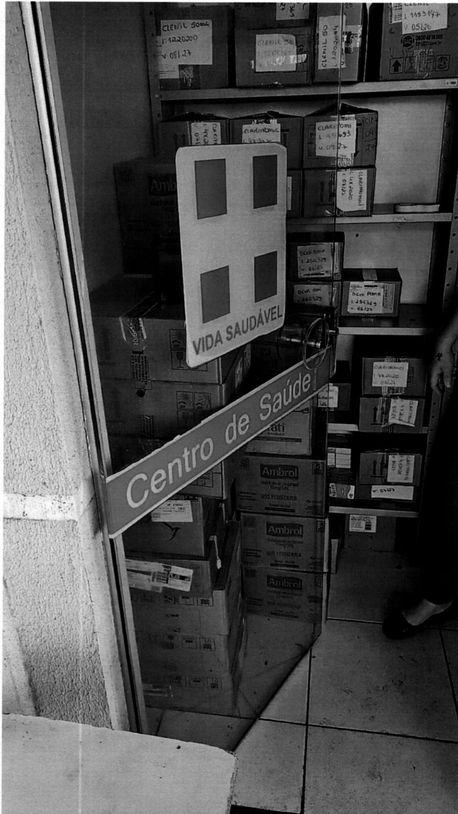
Porta de entrada do deposito, comprometida a entrada(sem espaço para abrir)
