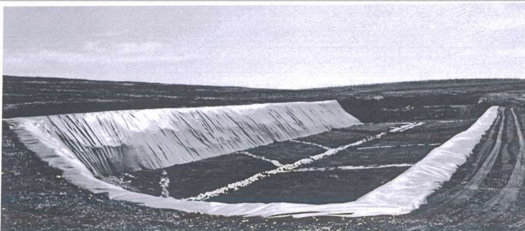
Figura 1: Célula de disposição final de resíduos classe II, evidenciando os drenos de captação de chorume.
